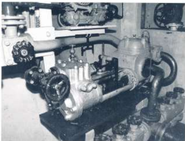
Duplexpumpen (Worthington) en viktig del i maskineriet. Angdelens närmast och pumpdelen bortanför. Övanför skymtar "Kermit". Foto: Bo Starmark.
